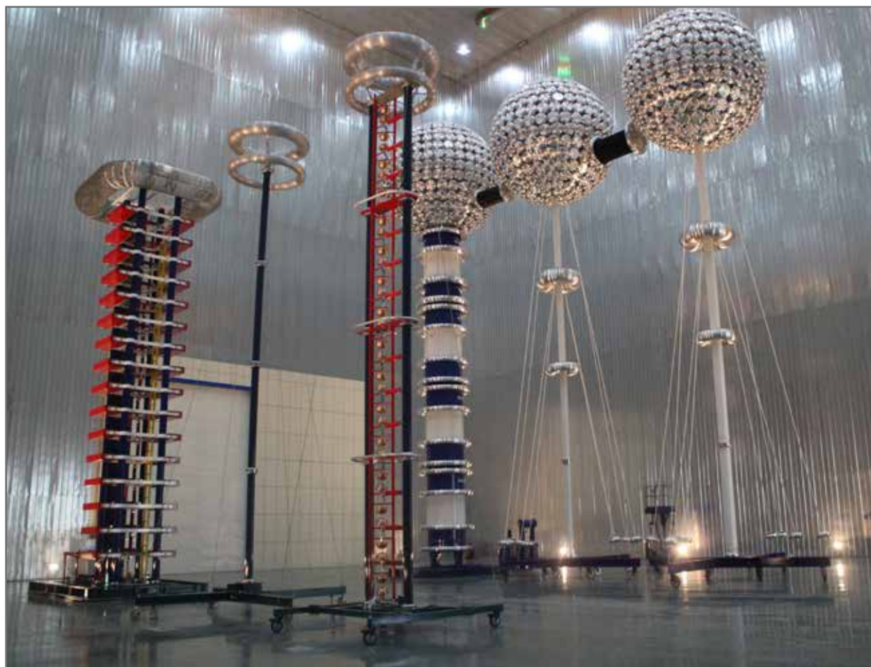
TE昆山高電圧試験所
