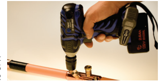
Conector de Cobre Shearbolt instalado en cable 4/0 kcmil 15 kV con aislamiento EPR
